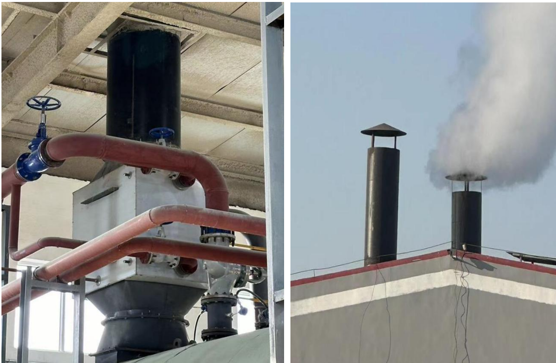
低氮燃烧器+12m 高排气筒
