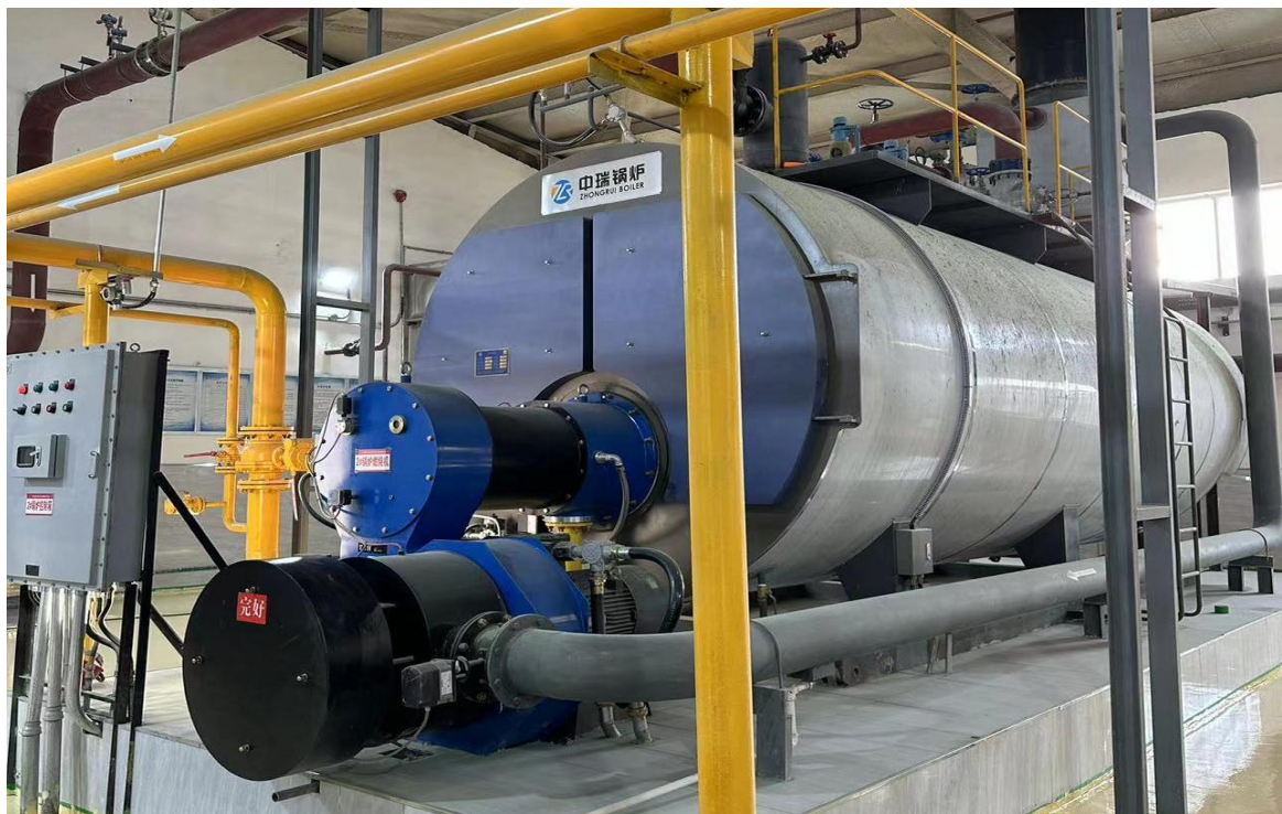
2#燃气热水锅炉
