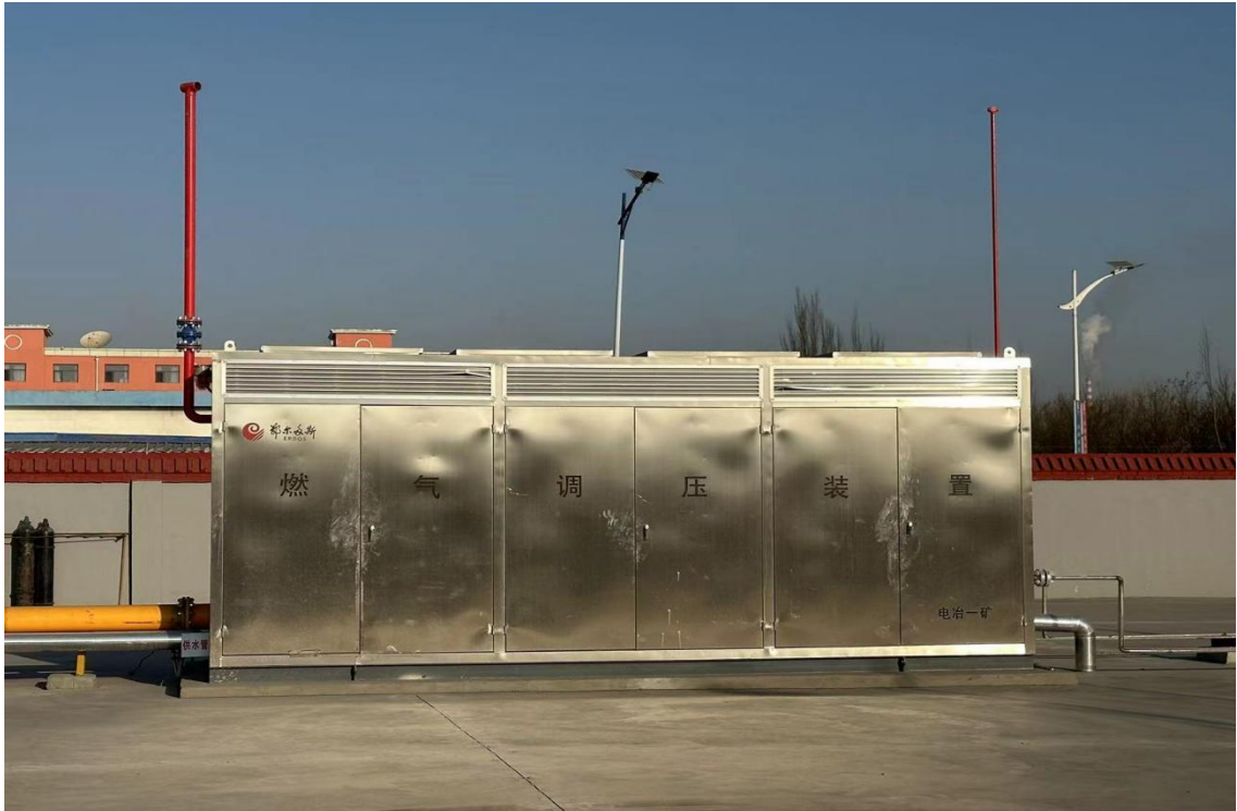
燃气调压装置
