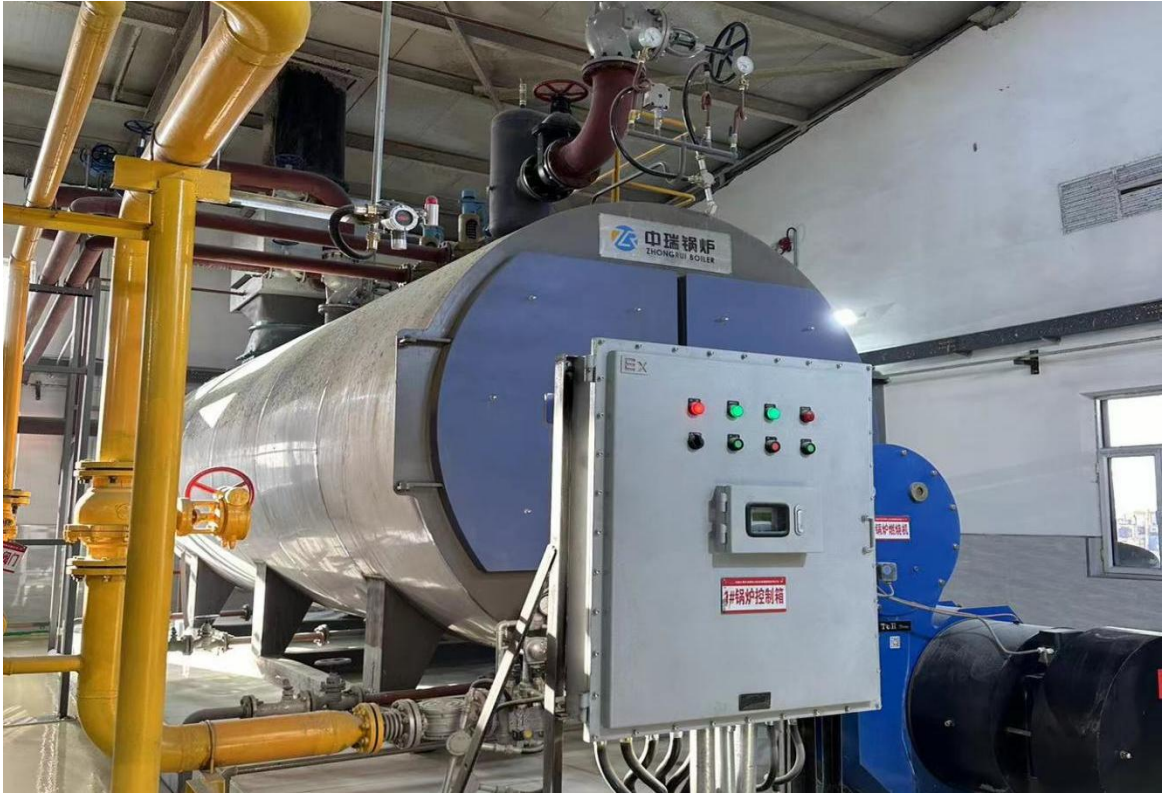
1#燃气热水锅炉
